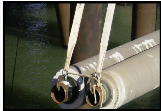
Vista de caños para crudo
